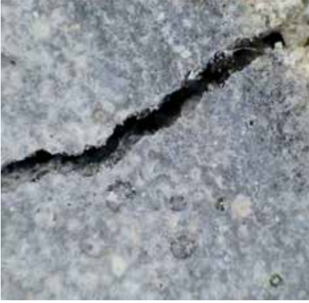
AQUAFIX uygulanmamış beton kırı (0,5 mm çatlak)
